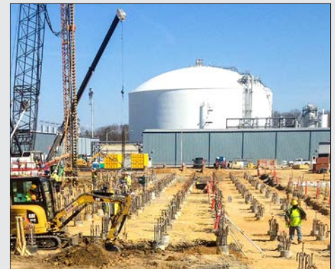
Dominion Cove Point LNG Terminal
